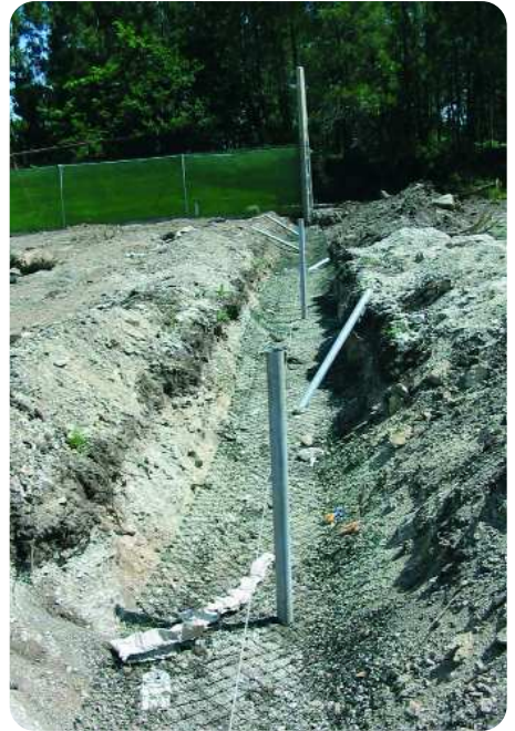
Zanja externa con protección anti-fuga.
